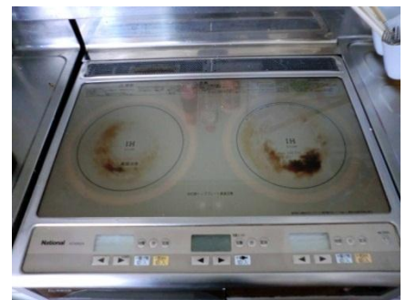
P様宅のIHキッキングヒーター(2口)
